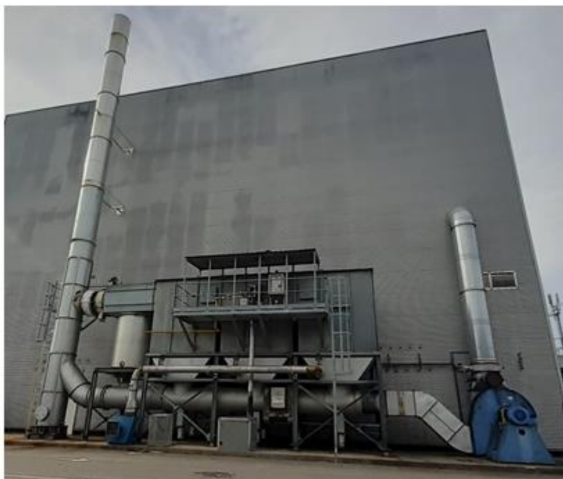
Figura 4 - Sistema de Tratamento de efluentes gasosos por oxidação térmica regenerativa (RTO)
