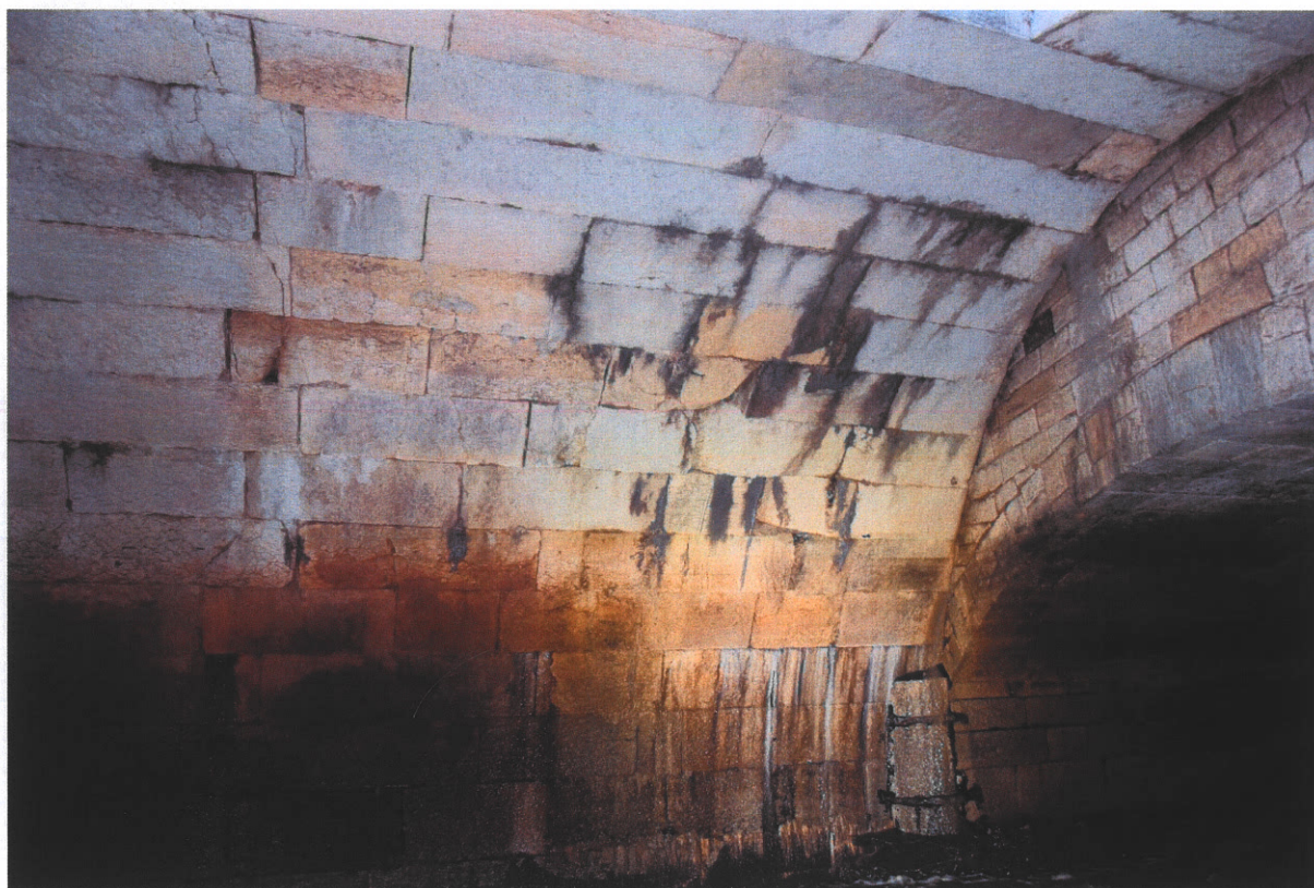
Fotografia 2 – Fissuras transversais, infiltrações, deslocamentos de blocos e esmagamento
