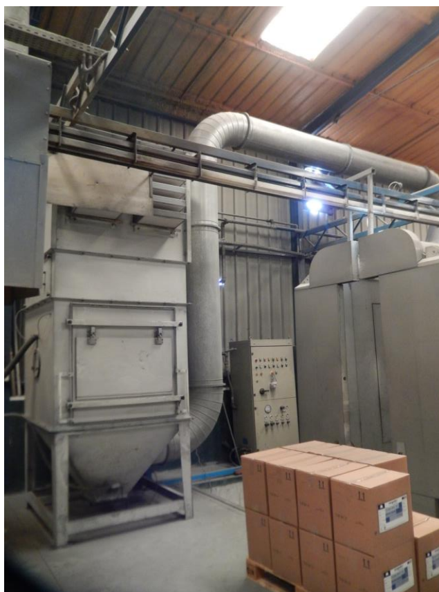
Figura 15 – Cabine de Pintura (Lacagem)
