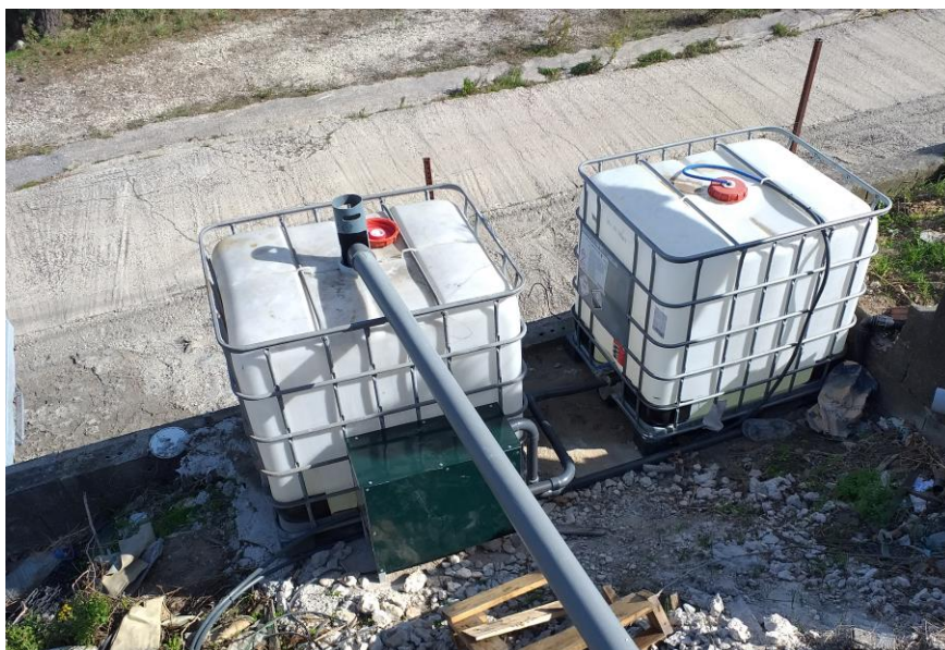
Figura 26 – Armazenamento de lamas – Recolha de Escorrências
