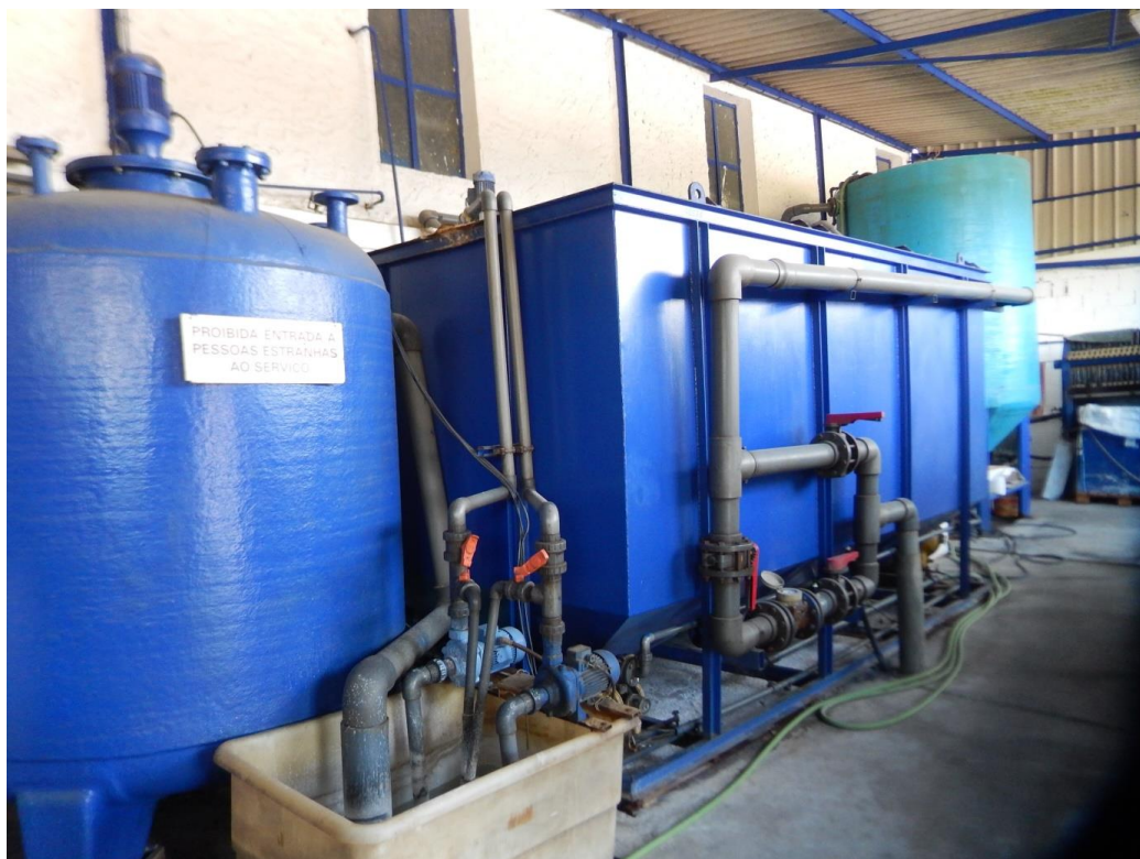
Figura 24 – Tanques do Tratamento dos Efluentes
