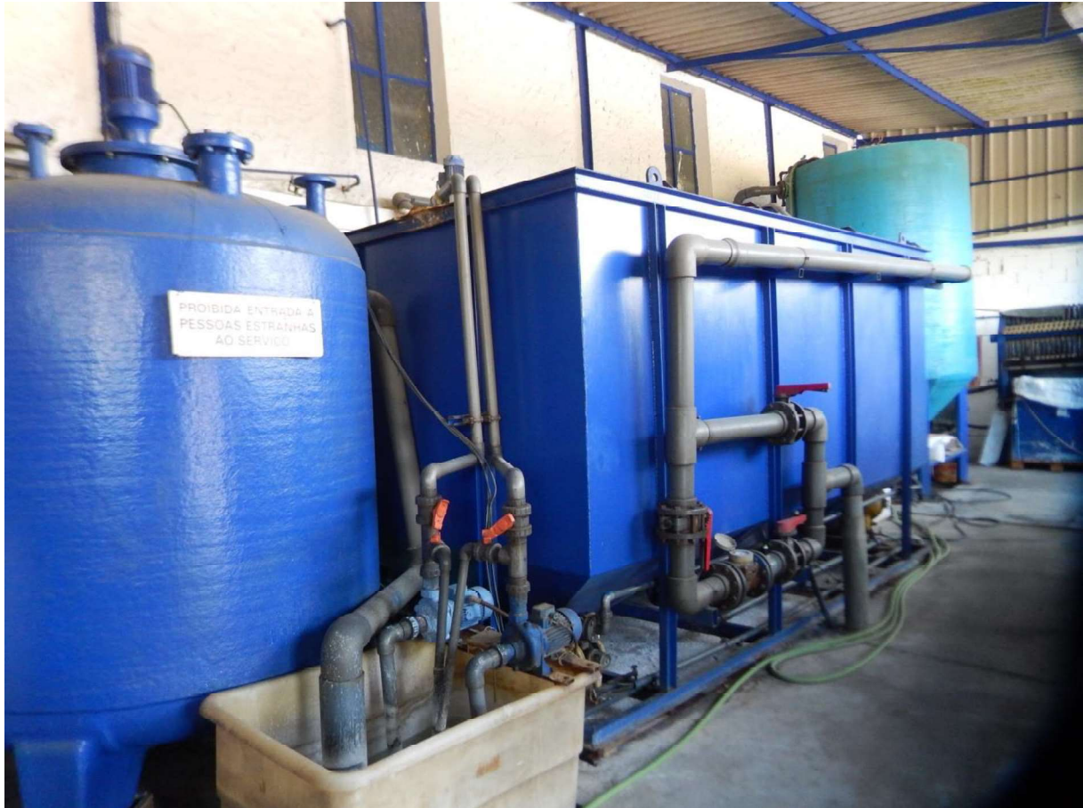
Figura 1 – Tanques do Tratamento de Efluentes
