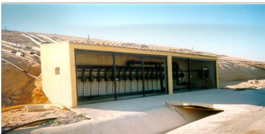
Figura 16: Estação de regulação com tubagens secundárias.
