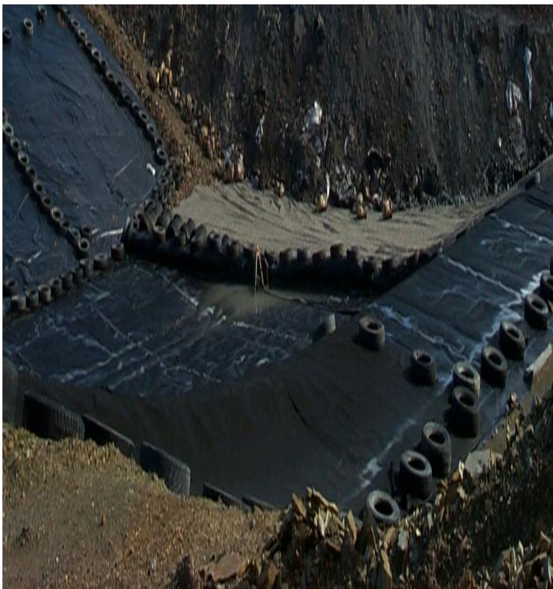
Figura 13: “Rain Flap” – separador hidráulico.
