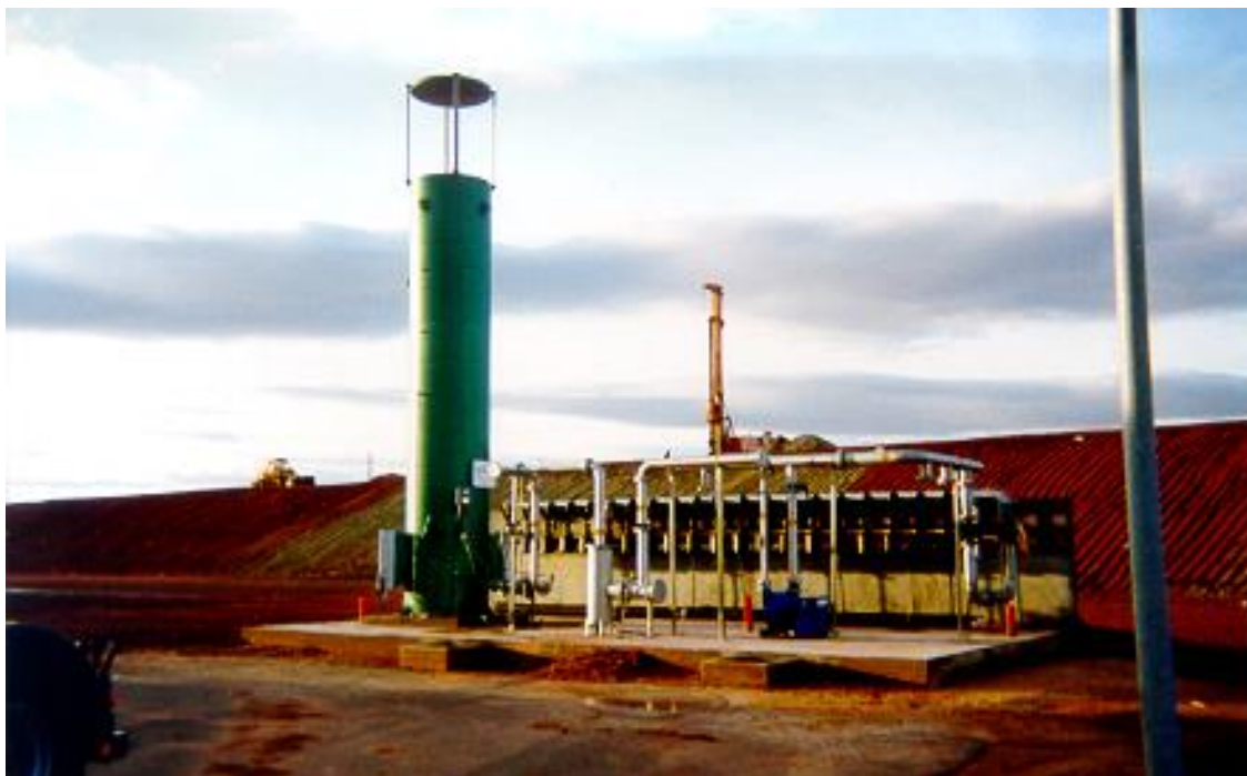
Figura 18: Queimador numa Central de Aspiração e Combustão.
