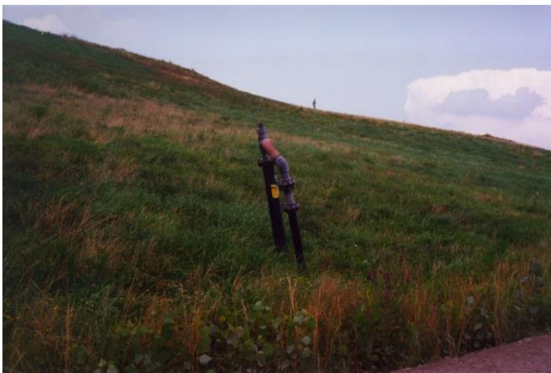
Figura 15: Cabeçote de poço de extracção de biogás.
