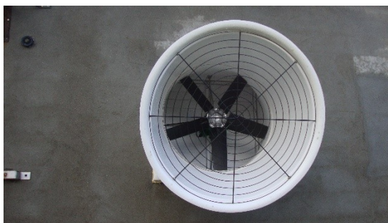
Fig. 2- exemplo de ventilador
