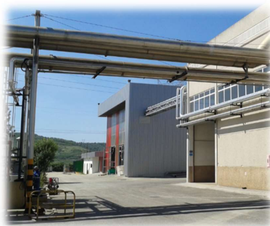
Figura 14 - Local de trasfega de S14 - fuelóleo recuperado
