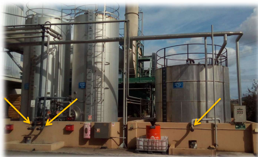
Figura 11 – Local de armazenagem LA2 e identificação das condutas utilizadas para abastecimento dos depósitos de 30 m 3 e 50 m 3
