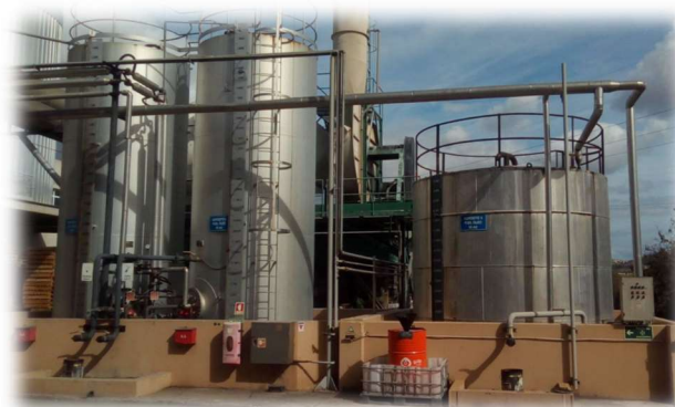
Figura 17 – Identificação dos reservatórios de armazenagem
