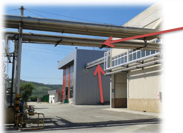
Figura 16 – Identificação das tubagens de alimentação de combustível S14 – Fuelóleo Recuperado
