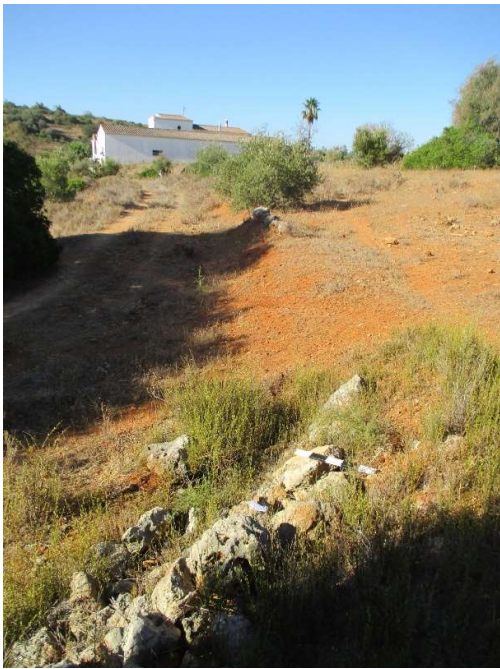
Figura 51- Vista geral da localização de muros de contenção de terras junto ao caminho, Quinta dos Poços 13
