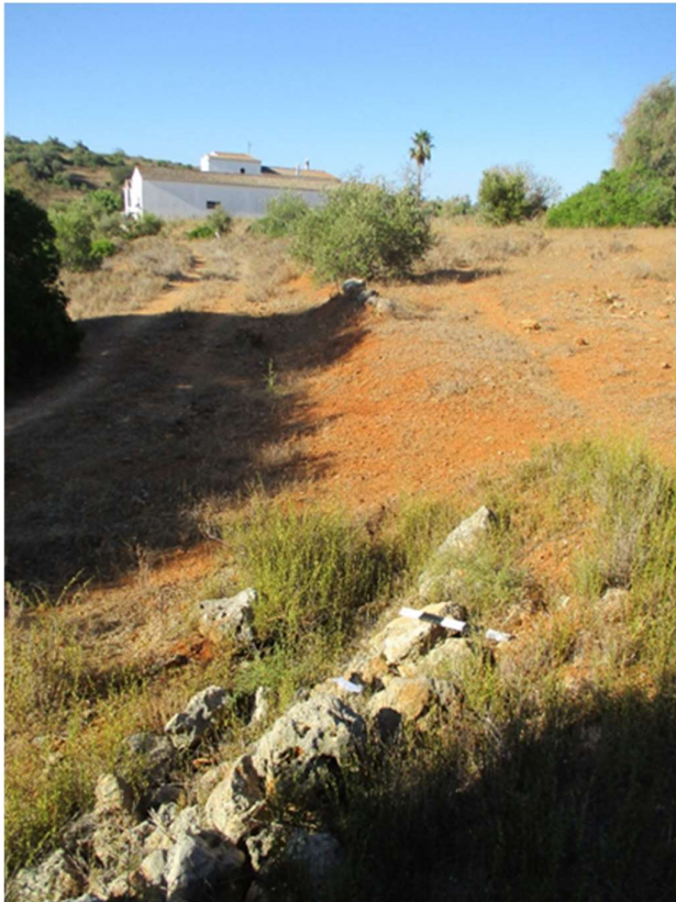
Figura 51- Vista geral da localização de muros de contenção de terras junto ao caminho, Quinta dos Poços 13
