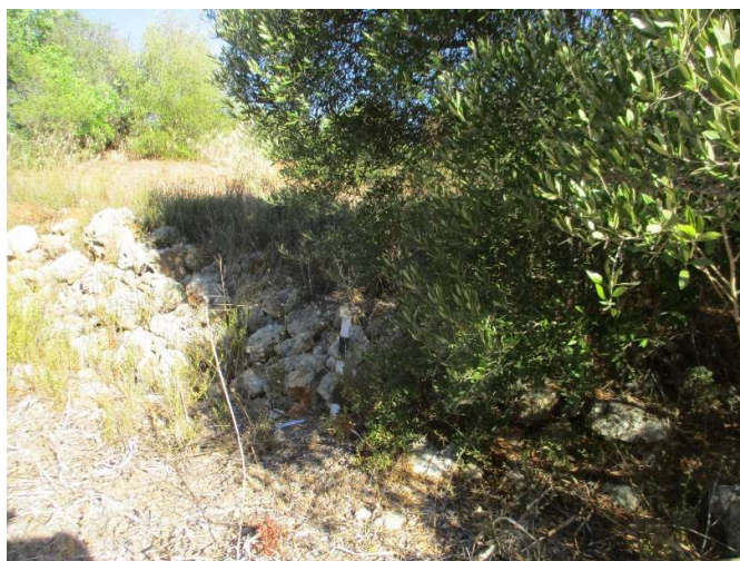
Figura 50-Alçado Sul de muro de contenção de terras junto ao caminho, Quinta dos Poços 13
