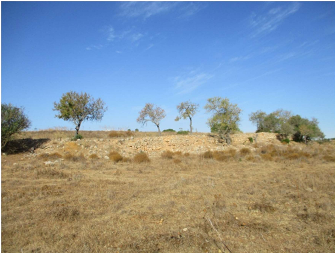
Figura 34- Vista geral de muro de contenção de terra a delimitar a base Nordeste da colina a Nordeste da Quinta dos Arcos 3
