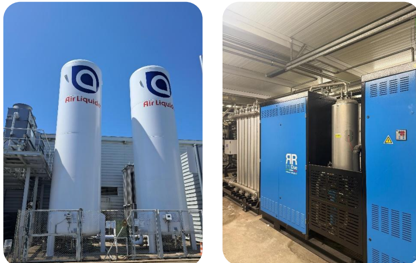
Figura 16. Exemplo dos tanques de armazenamento de nitrogénio e dos equipamentos de produção interna.
