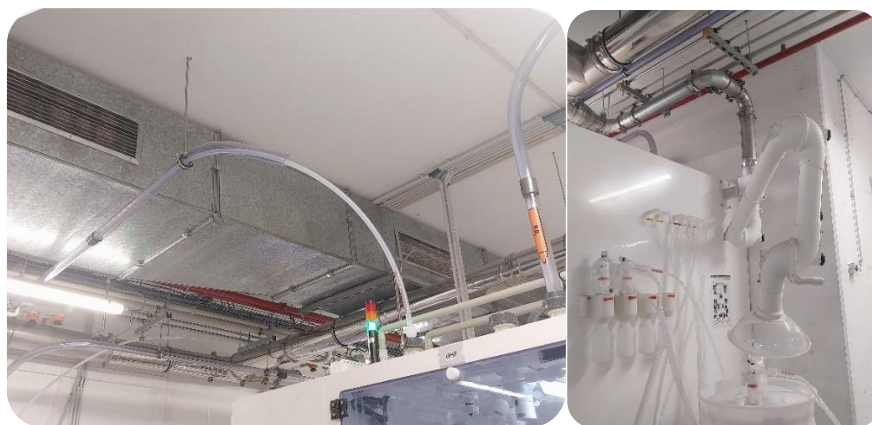
Figure 10. Exemplos da exaustão existente – em geral na sala e localizada nos equipamentos.
