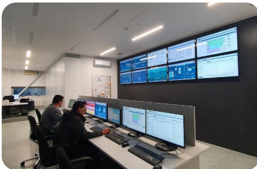
Figura 8. Sala de monitorização BMS.
