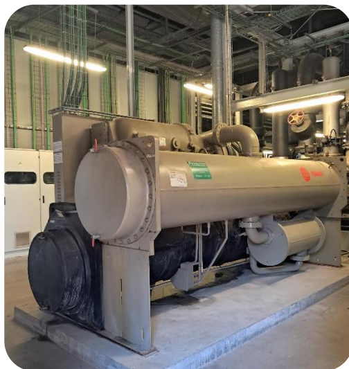
Figura 12. Exemplo de Chiller.
