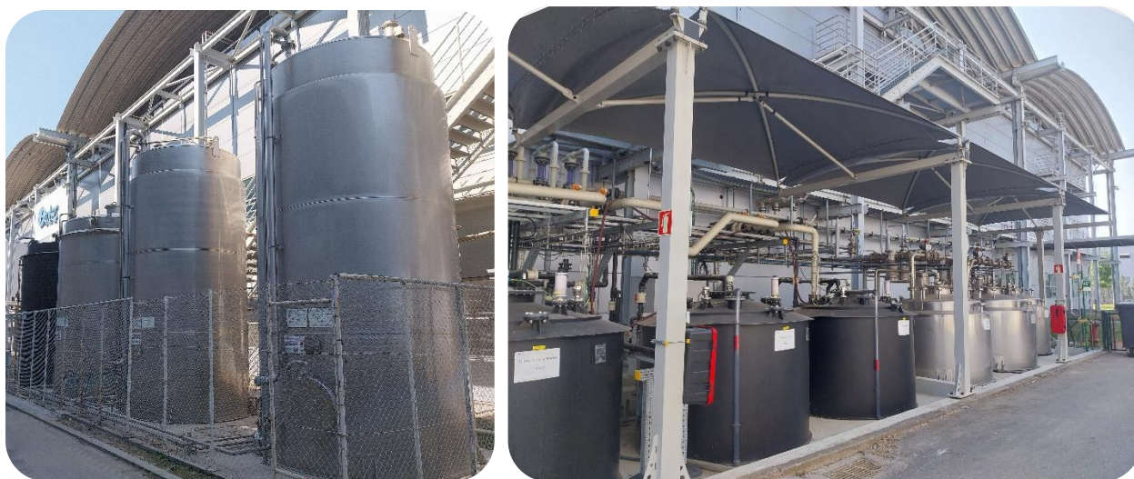
Figure 7. Área de tanques de armazenamento intermédio de resíduos solventes líquidos para envio para OGR e efluente para encaminhamento para a ETAR.
