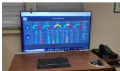
Imagem do novo software/sistema de inteligência operacional com tecnologia OSIsoft, suportando a implementação dos princípios da Indústria 4.0 ao nível de eficiência de processos.
