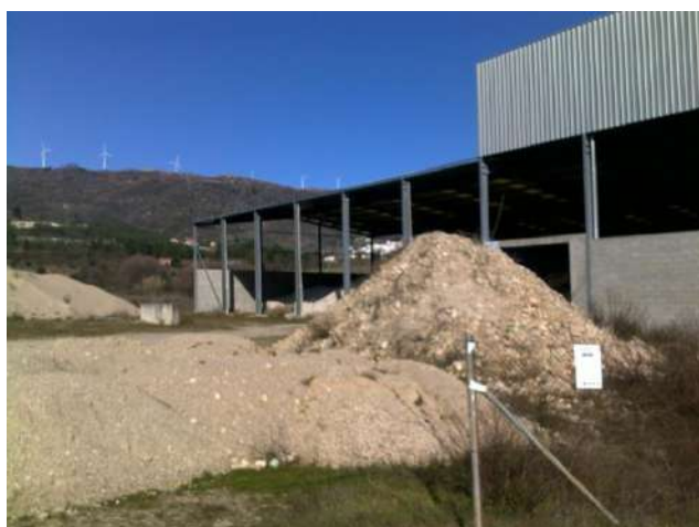
Figura 4.7.1 - Localização da área de apoio de obra e estaleiro e estado atual.
