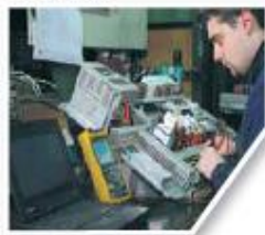
Cableado de cuadro eléctrico Control panel wiring
