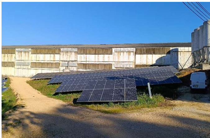
Figura 6.1 – Vista para os painéis fotovoltaicos
