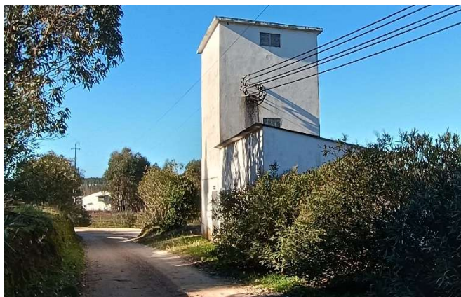
Figura 6.3 - Vista para o Posto de Transformação
