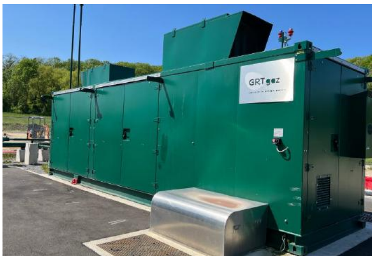
Figura 10. Exemplo de compressor operado pelo operador da rede de transporte de gás francesa.
