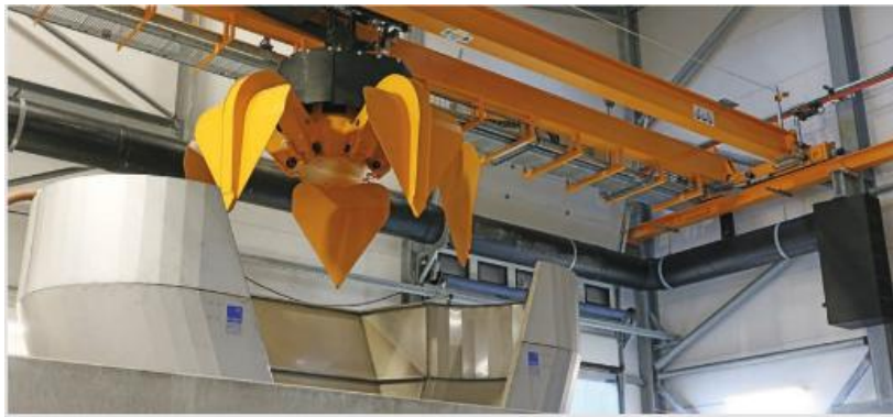
Figura 18. Exemplo de um biomixer carregado por ponte rolante equipada com garra.
