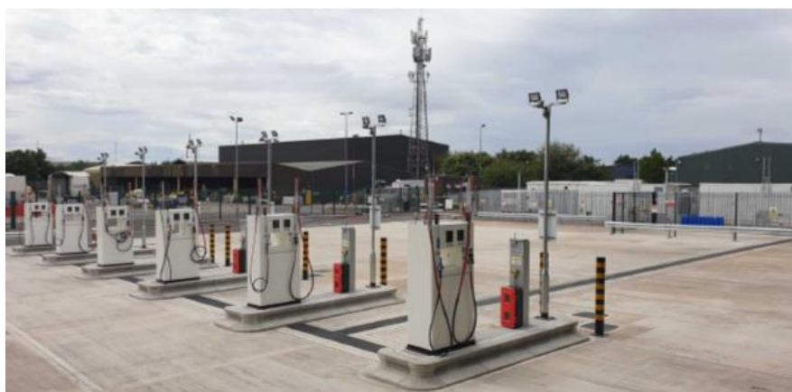
Figura 11. Exemplo de conjunto de estações de enchimento de trailers de BioGNC.
