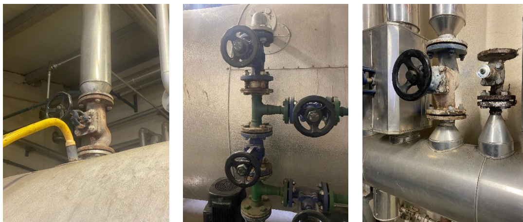
Figura 6 - Acessórios sem isolamento térmico
