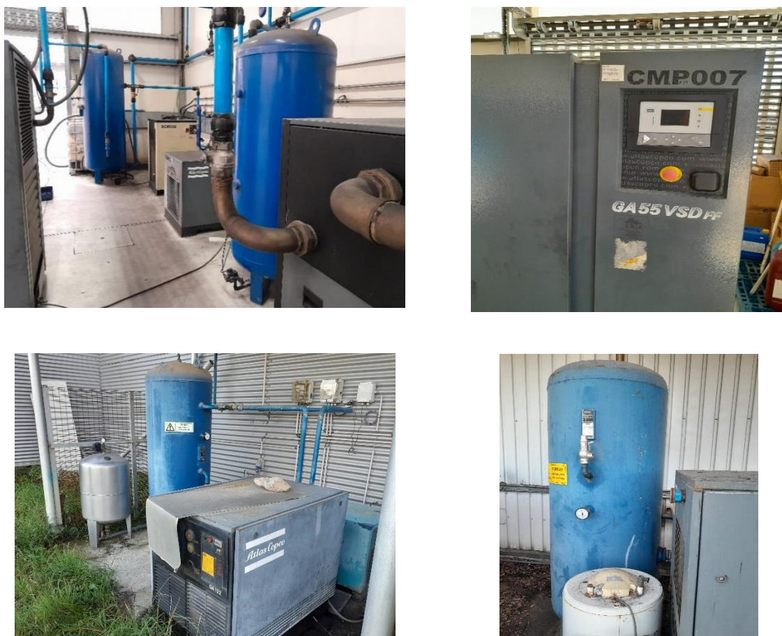
Figura 4 - Central de ar comprimido da Fábrica e da Armazém
