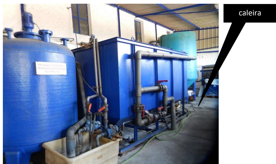
Figura 5 – Caleira de Recolha de derrames na ETARI
