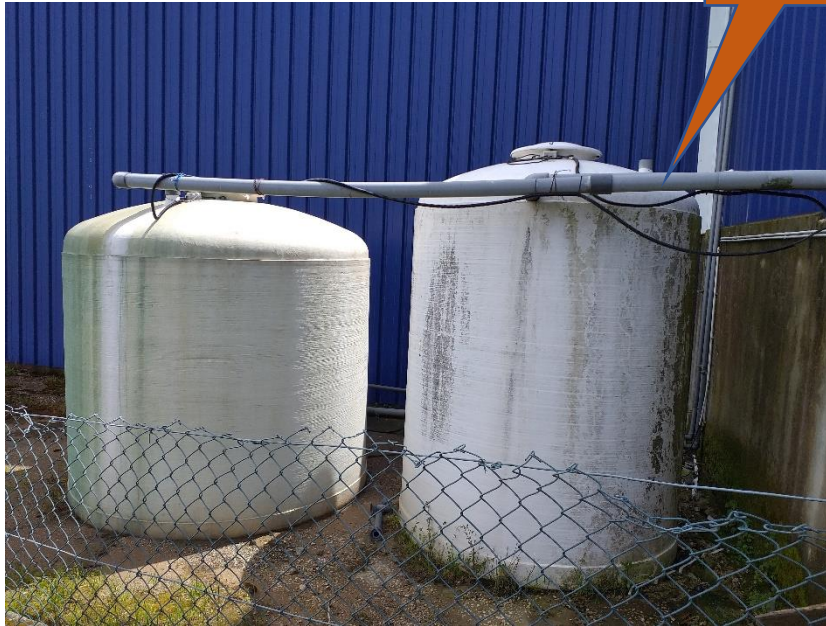
Figura 4- Efluentes Edifício3 -Lacagem
