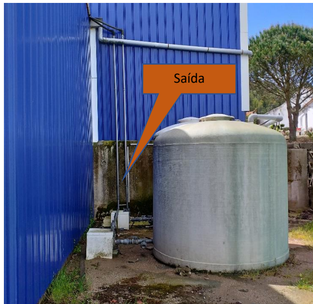
Figura 3Reservatórios Efluentes Edifício3 -Lacagem
