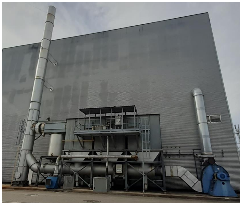
Figura 7: Sistema de Tratamento de efluentes gasosos por oxidação térmica regenerativa (RTO)
