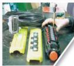
Cableado de balonera Pendant control wiring
