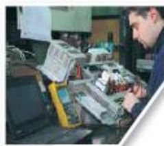
Cableado de cuadro eléctrico Control panel wiring
