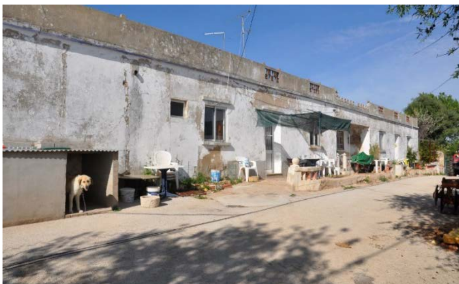
Figura 4– Aspeto exterior das edificações preexistentes evidenciando a precariedade construtiva e arquitetónica.
