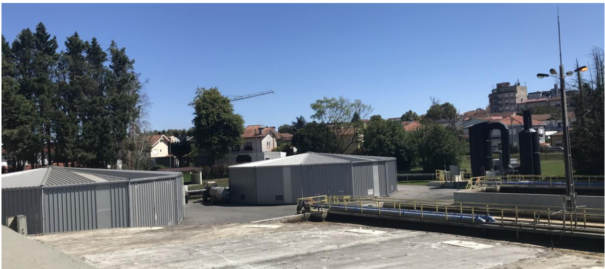
Foto 12.1 – Torres de desodorização: em cima a torre é responsável pela desodorização da obra de entrada e do edifício de lamas, em baixo a torre é responsável pela desodorização dos decantadores primários.
