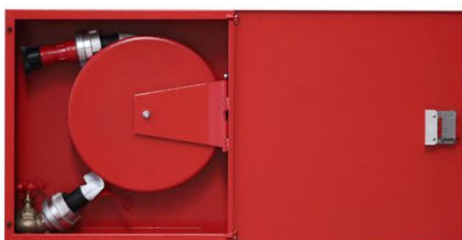
Figura 25- Exemplo de boca incêndio BITT, instalada em armário
