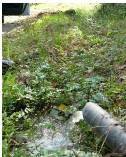
Figura 4.7.6 - Drenagem informal de águas pluviais (D2)
