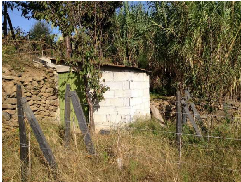
Figura 4.4.3 - Possível furo localizado na parcela contígua à área da unidade hoteleira (a noroeste)
