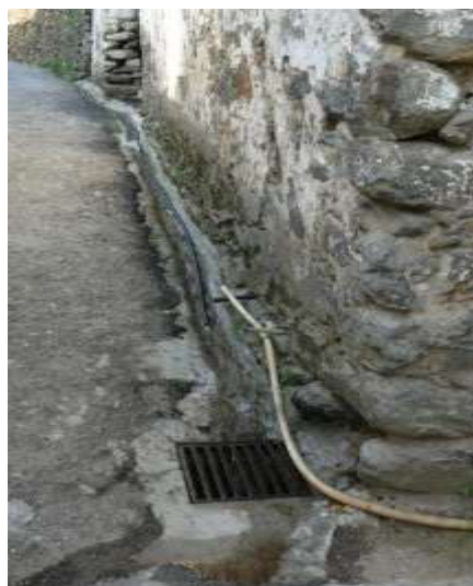
Figura 4.7.5 - Drenagem com recolha de águas pluviais em coletor (D1)
