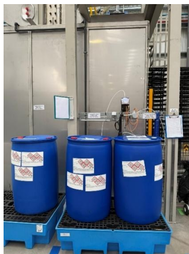
Figura 9. Sistema de adição do desgordurante ao banho.
