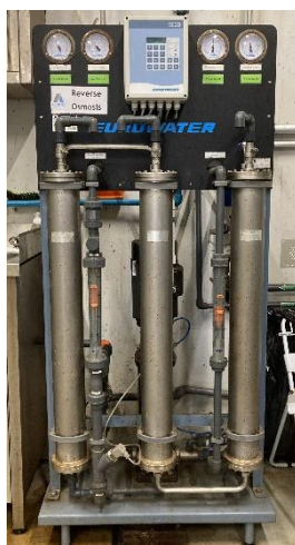
Figura 17. Unidade de osmose inversa.
