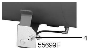
Válvula de drenagem de condensados no reservatório de ar
