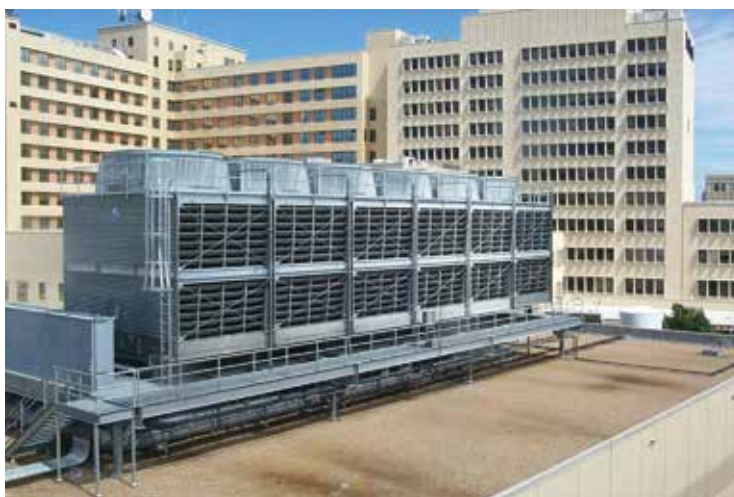
Figura 4: Condensador evaporativo localizado no exterior das instalações
