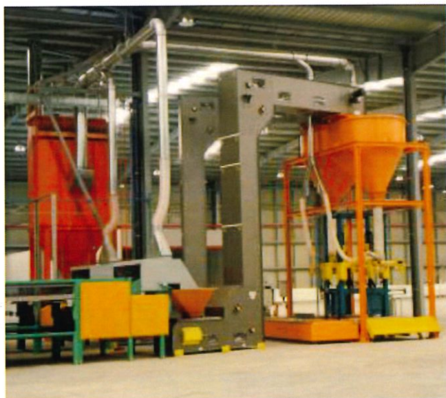
Instalação de despoeiramento
