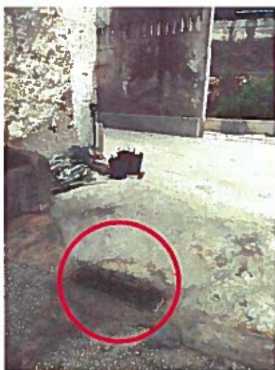
Foto 3 – Encaminhamento das escorrências da nitreira (grelha com ligação ao tanque de receção)
