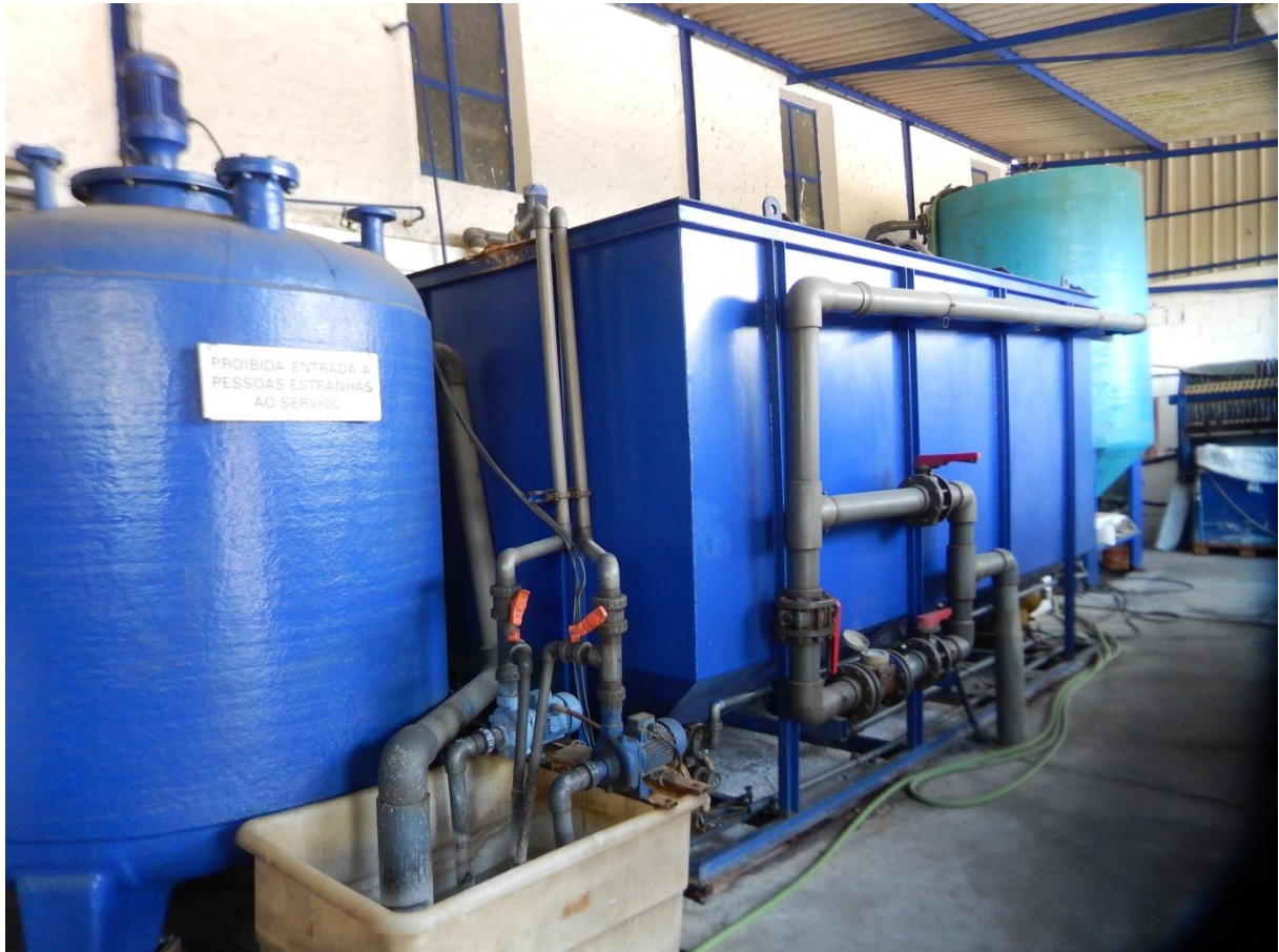
Figura 1 – Tanques do Tratamento de Efluentes
