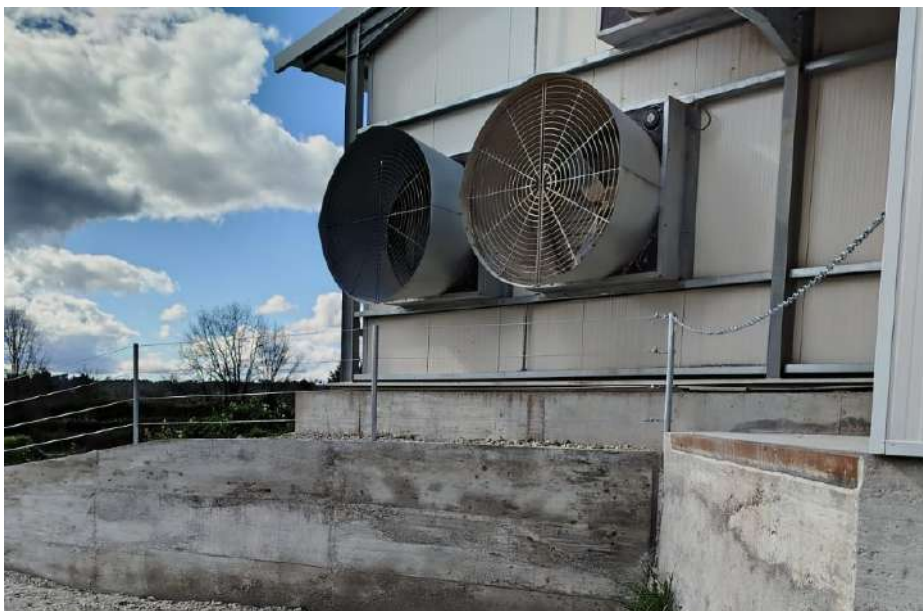
Fig. 2- exemplo de ventilador
