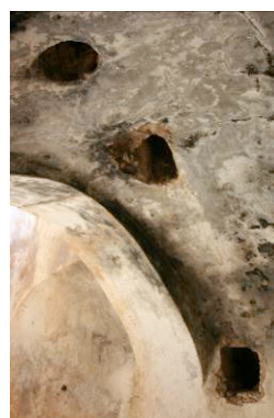
18 – Oc. 2, Piso térreo, perfurações de mecanismo na cobertura
