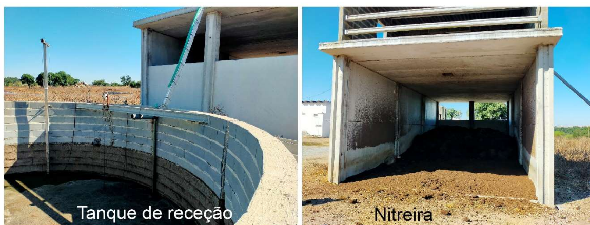
Figura IV.1 – Poço de receção de efluentes pecuários e nitreira. Aspeto das infraestruturas em julho 2024.
