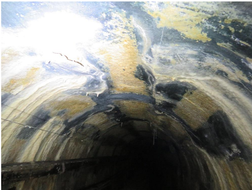
Foto 3 – Estado do hasteal do Aqueduto ao PK 0+315m da obra por infiltrações exteriores com incrustações calcárias
