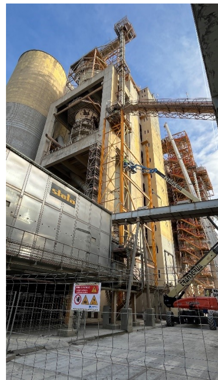
Vista da torre do queimador auxiliar, para onde serão transportados os CDR do CA5
