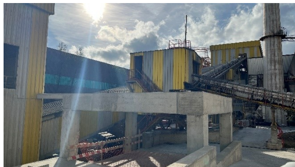
Base para o britador de argila crua
