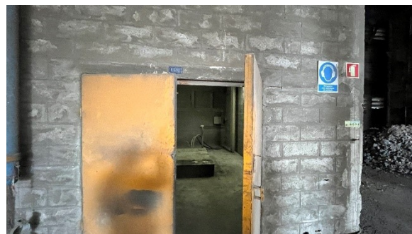
Compartimento de sopradores para alimentação de CDRs
