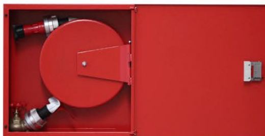
Figura 23- Exemplo de boca incêndio BITT, instalada em armário
