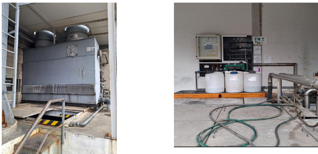
Figura 17. Torres de refrigeração e doseamento de produtos químicos aos circuitos de água de arrefecimento
