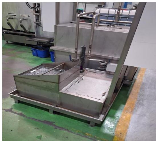
Figura 4. Armazenamento de água de lavagem no setor de maquinagem
