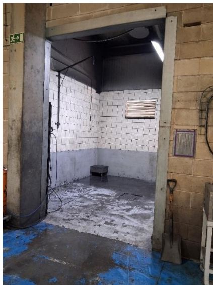
Figura 7. Área de lavagem de moldes com ligação ao Tanque de emulsões oleosas
