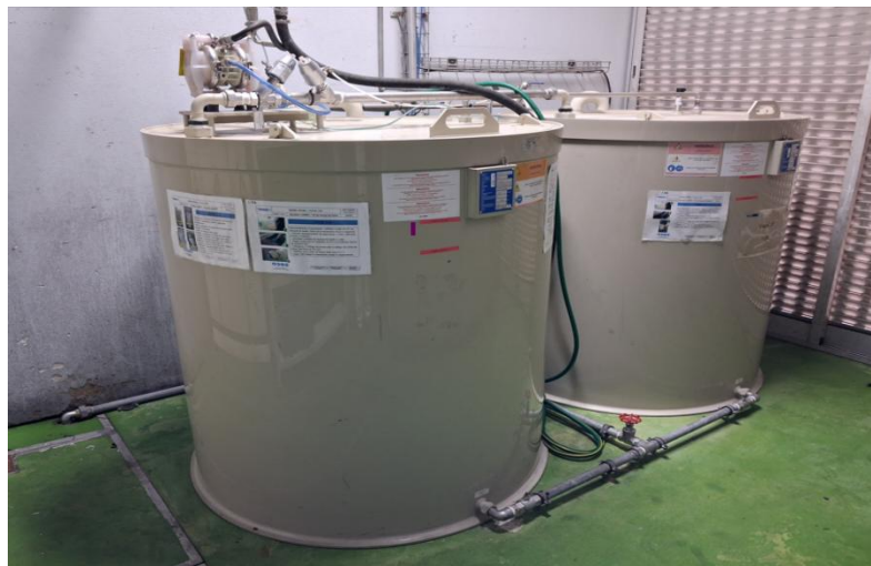
Figura 11. Tanques de lavagem alcalina e ácida da VACUDEST
