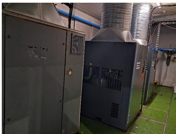
Figura 18. Sala dos compressores
