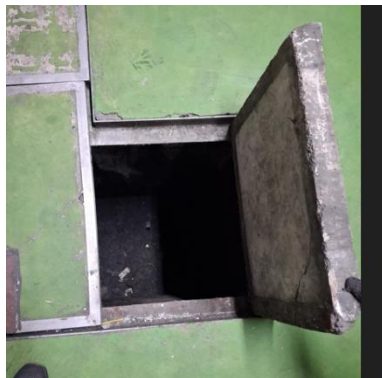
Figura 14. Tanque de contenção no pavimento da sala da VACUDEST
