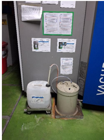
Figura 10. Equipamento VACUDEST e armazenamento de produtos químicos que são automaticamente abastecidos ao equipamento
