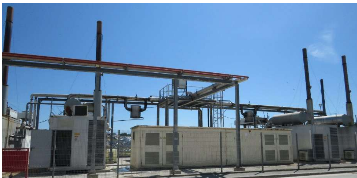
Figura 6-3 – Cogeneradores do sistema de aproveitamento energético do biogás da CITVRSU
