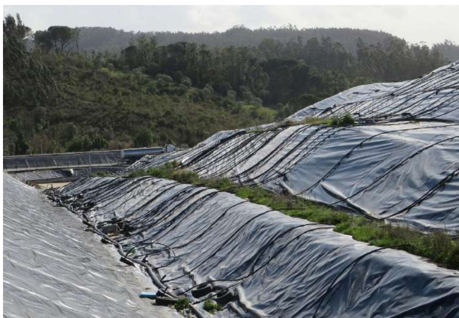
Figura 6-1 – Extração de biogás da Fase A + A2, março 2022
