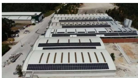
MARFILPE, S.A. Alcobaça UPAC de 305 kWp
