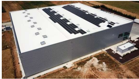
MENDES GONÇALVES, S.A. Golegã 2 UPAC de 656 kWp
