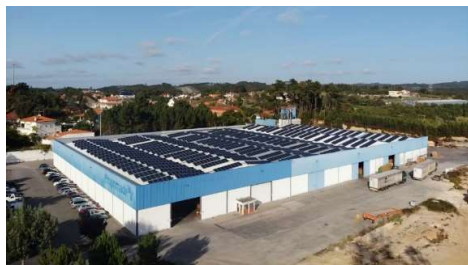
EMPRIMADE, S.A. Caranguejeira UPAC de 460 kWp
