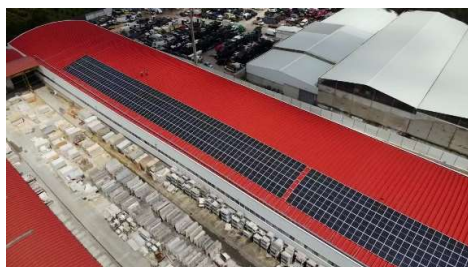
MVC, S.A. Ataija de Cima UPAC de 264 kWp
