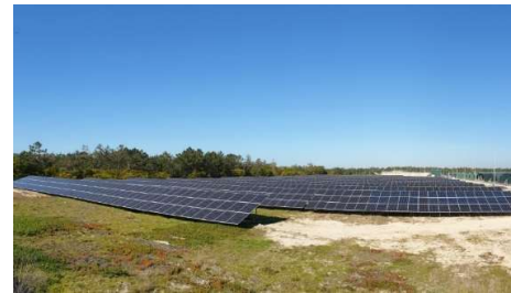
PESCANOVA, S.A. Praia de Mira UPAC de 895 kWp
