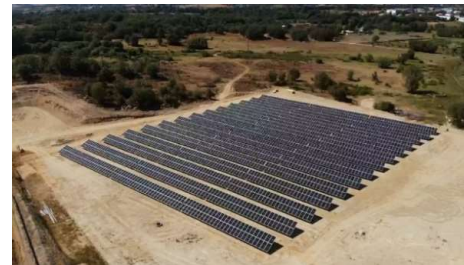
GRUPO RESPOL Fundão UPAC de 1.000 kWp
