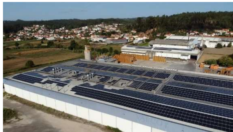
VALCO, S.A. Leiria UPAC de 1.000 kWp
