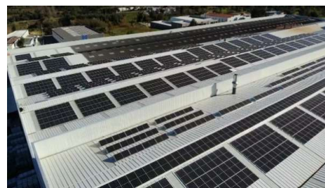
PAVIGRÉS, S.A. Mortágua UPAC de 1.000 kWp
