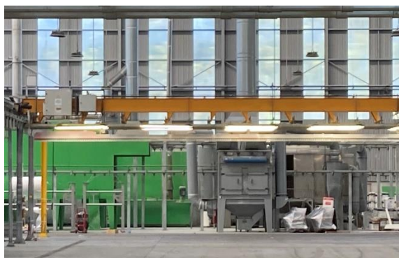
Figura 19 – Linha automática de lacagem.
