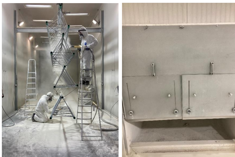
Figura 15 – Cabine de pintura a pó (sistema de exaustão na lateral de ambos os lados, com filtros, 9 de cada lado).
