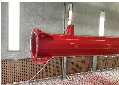
Figura 7 – Cabine de pintura líquida (sistema de filtros de cartão na lateral de ambos os lados, complementado com cassete de filtros antes da exaustão para a atmosfera).
