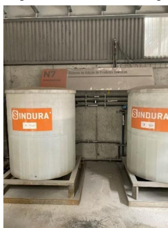
Figura 12 – Linha de pré-tratamento de alumínio.
