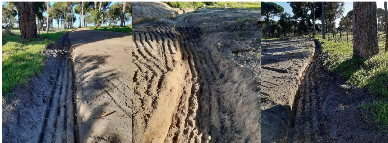
Figura 1 - Fotografias retiradas na propriedade representativas das valetas de encaminhamento das águas pluviais
