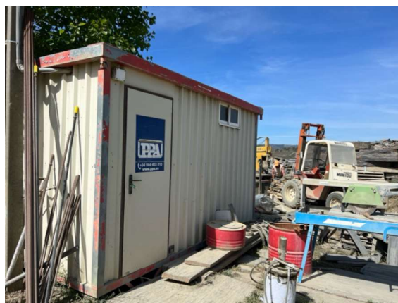
Figura 9: Fotografia do contentor utilizado para o escritório e arrumos e do contentor utilizado para as instalações sanitárias e balneário.
