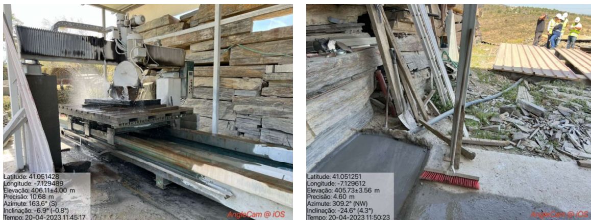
Figura 25: Fotografia da máquina de corte e dos tanques de decantação existentes associados ao sistema de recirculação de águas do corte.
