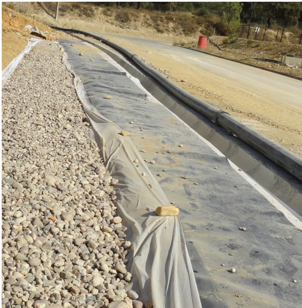
Figura 2 – Dreno periférico drenagem de águas lixiviantes – Requalificação realizada em 2013
