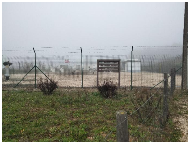
Fotografia 3.4 – Estação de Regulação de Pressão e Medição da Abrigada (GRMS 1319)
