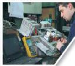
Cableado de cuadro eléctrico Control panel wiring
