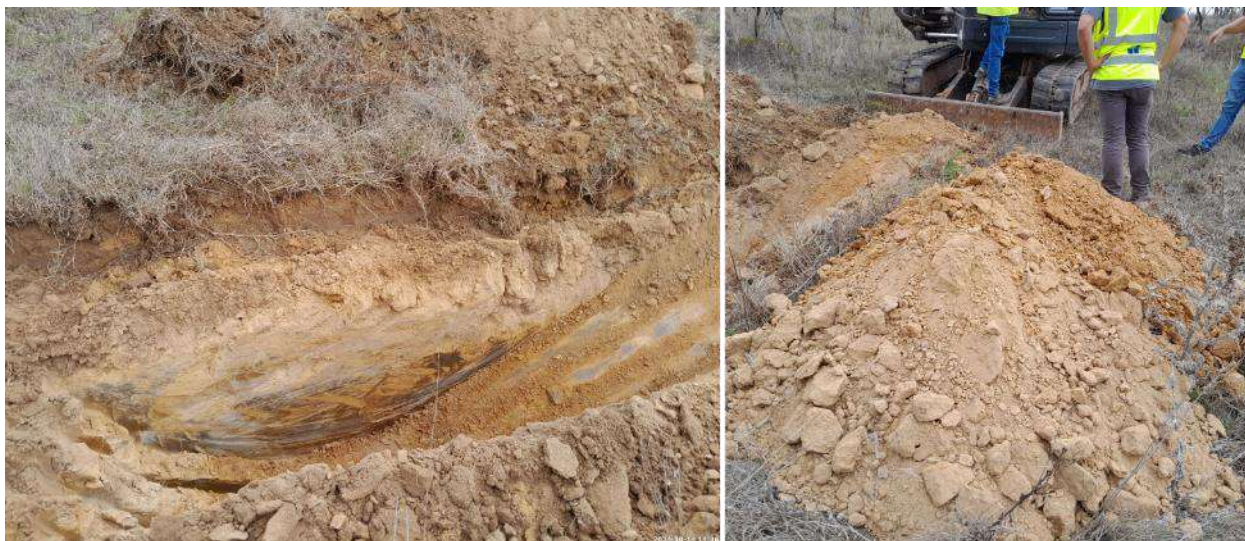
Figura 26 – Aspetto geral do poço P7
