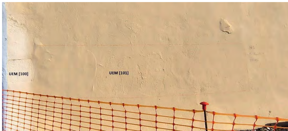
Figura 436 – Camadas de tinta superficiais na SP1.
