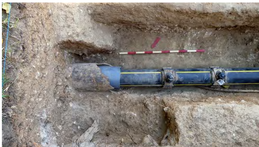
Figura 376 – Pormenor do intrincado de tubagens presentes na mesma infraestrutura.
