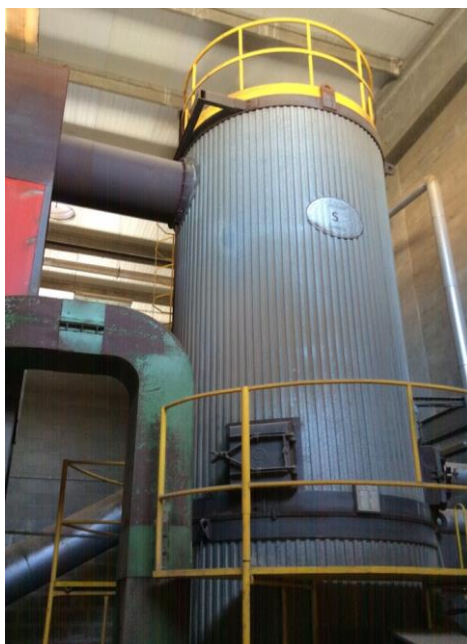
Figura 17 – Caldeira a pellets
