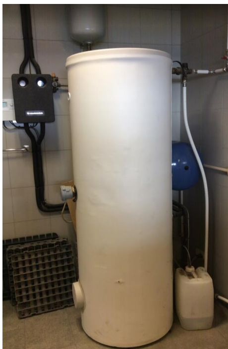
Figura 20 – Reservatório de acumulação de AQS
