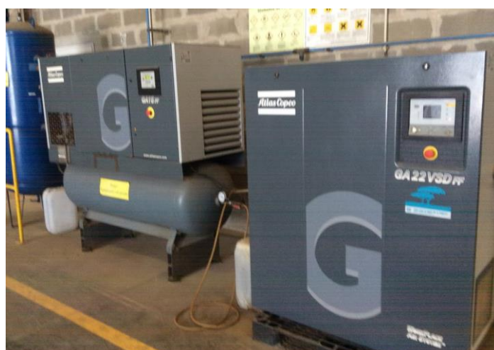
Figura 18 – Compressores da UTRO/UTFQ
