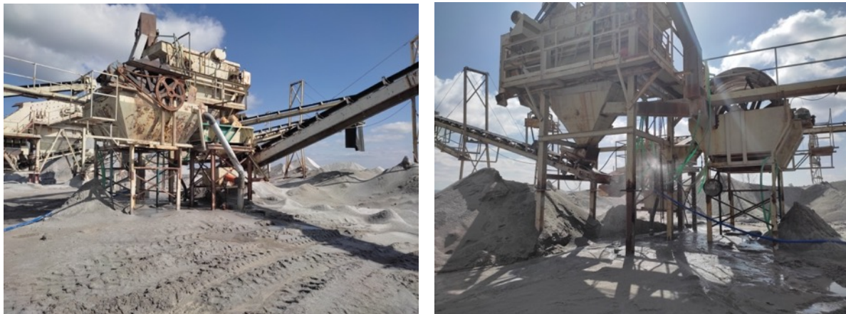
Figura 10: Fotografias do sistema de despoeiramento da britagem e do sistema de lavagem de areias.
