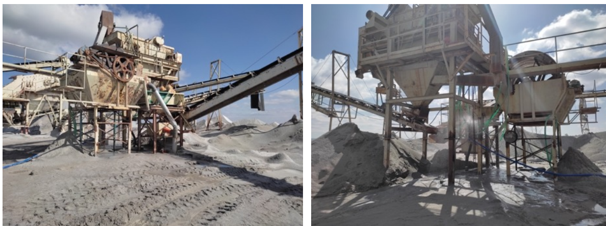
Figura 104: Fotografias do sistema de despoeiramento da britagem e do sistema de lavagem de areias.
