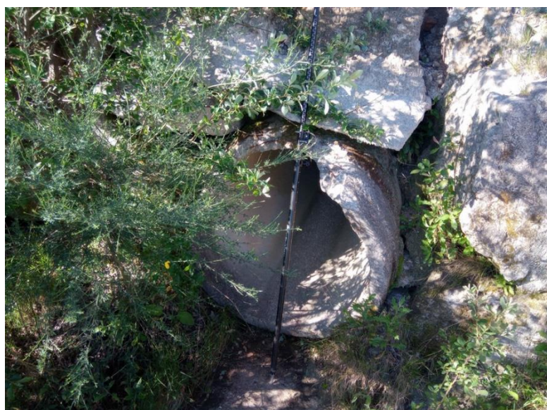
Figura 2 - Manilha da passagem hidráulica.
