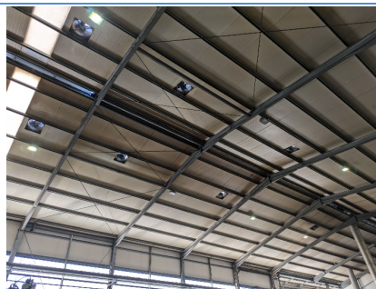
Figura 2 - Sistema de exaustão.
