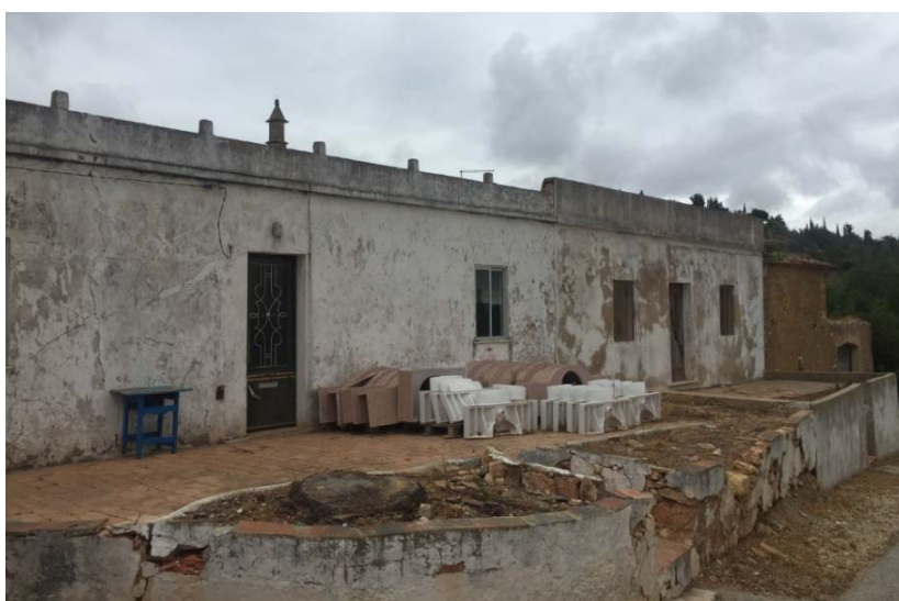
Figura 71 - Habitações a demolir.
